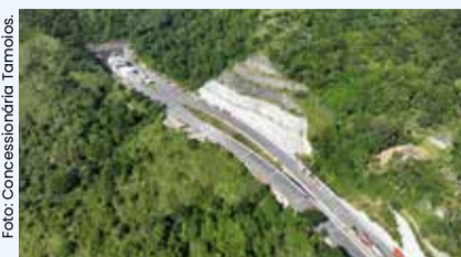
Transformando a mobilidade na região, a megaobra tem facilitado o deslocamento de motoristas entre as cidades.
