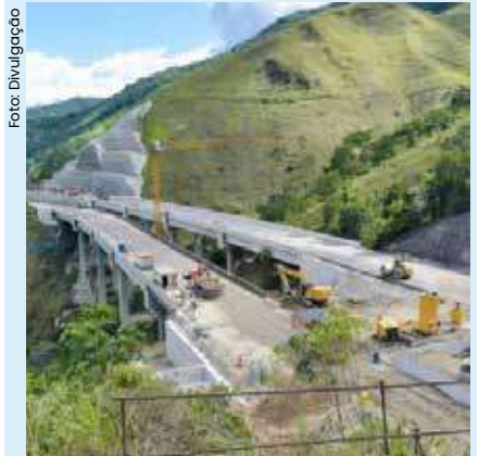
As obras dos Contornos vão facilitar o acesso direto ao Porto de São Sebastião.
